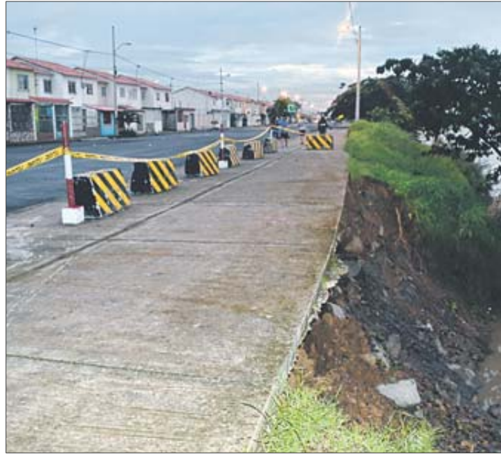
Estado. El área de peligro fue limitada por personal de Obras Públicas.
