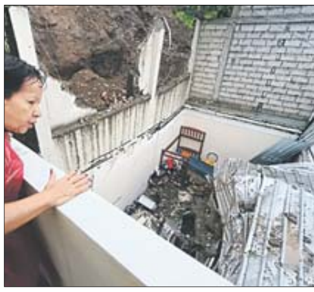
Riesgo. Varias viviendas están en peligro.
